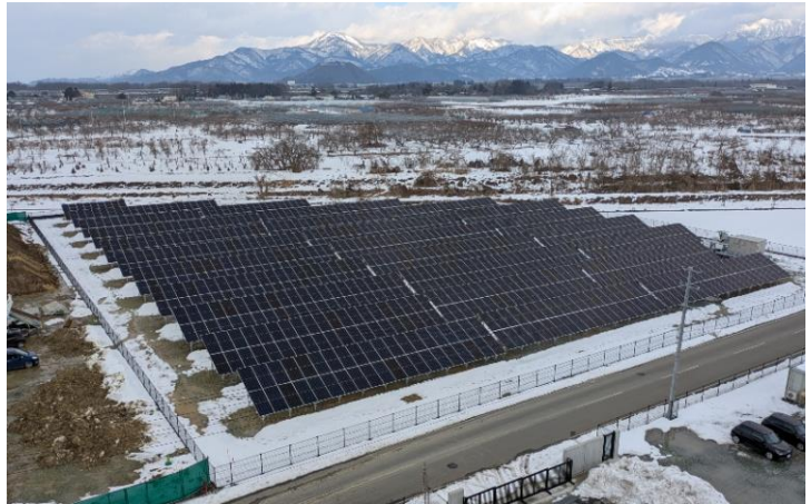
<天童工場：700kW PPA方式発電設備>
