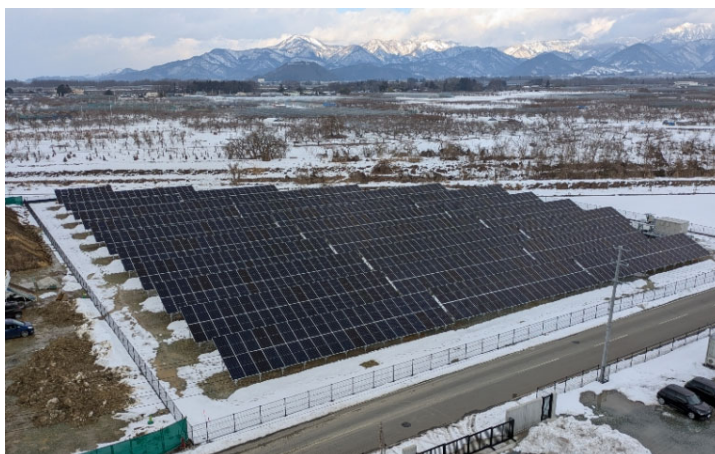
<天童工場：700kW PPA方式発電設備>
