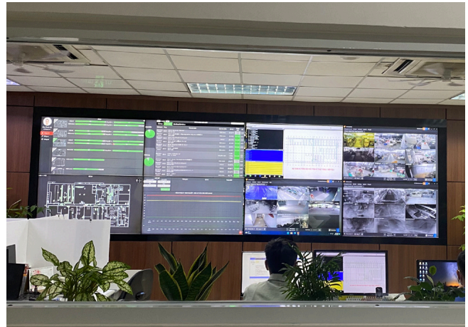
ベトナム工場防災センター
