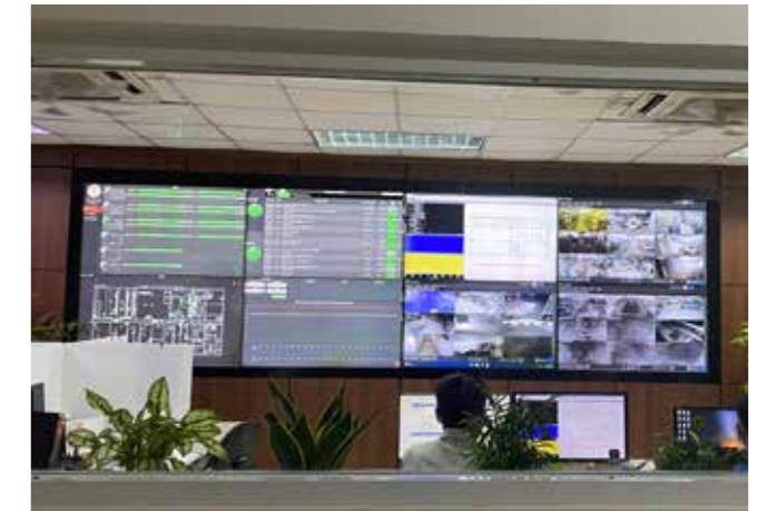
ベトナム工場防災センター
