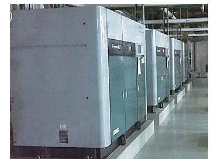
コンプレッサー
