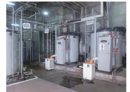
蒸気ボイラー
