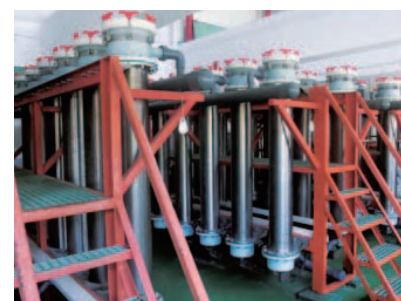
写真：広州工場のソフトエッチング廃液処理装置
